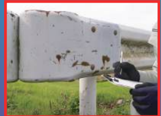
事故後の損傷箇所
